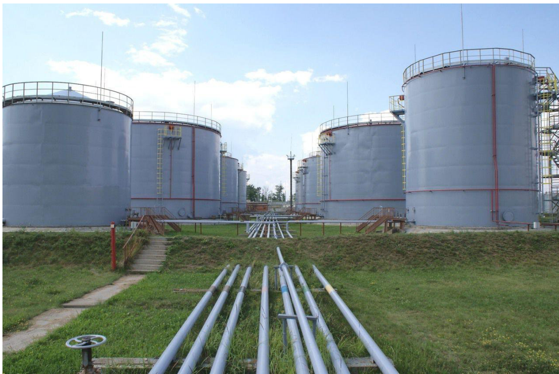
Рис. 4.3. Наземный стальной резервуар нефтепродуктов
