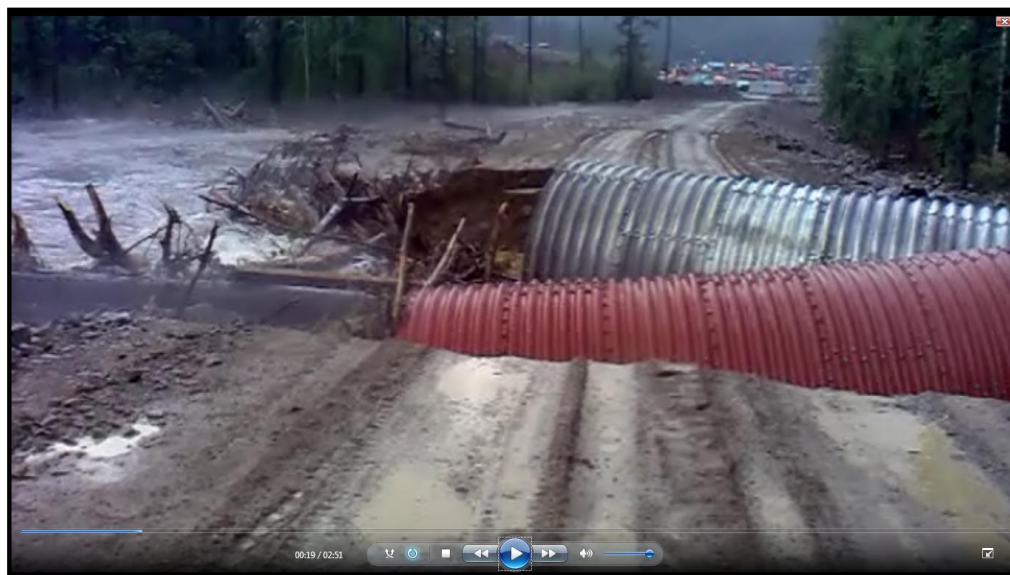
Рис. 1. Фрагмент видеоматериала с разрушенным участком автомобильной дороги
