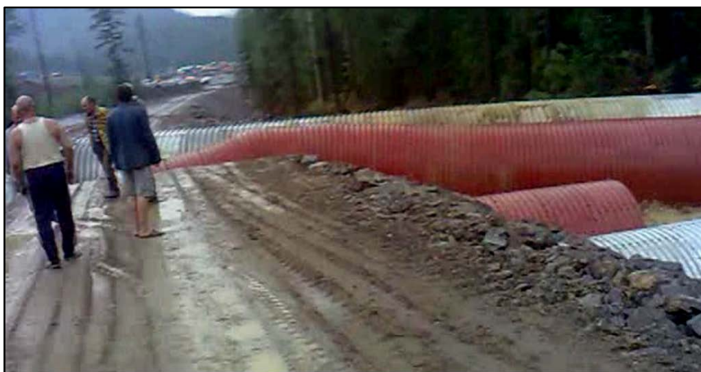
Рис. 3. Разрушение земляного полотна с низового откоса
