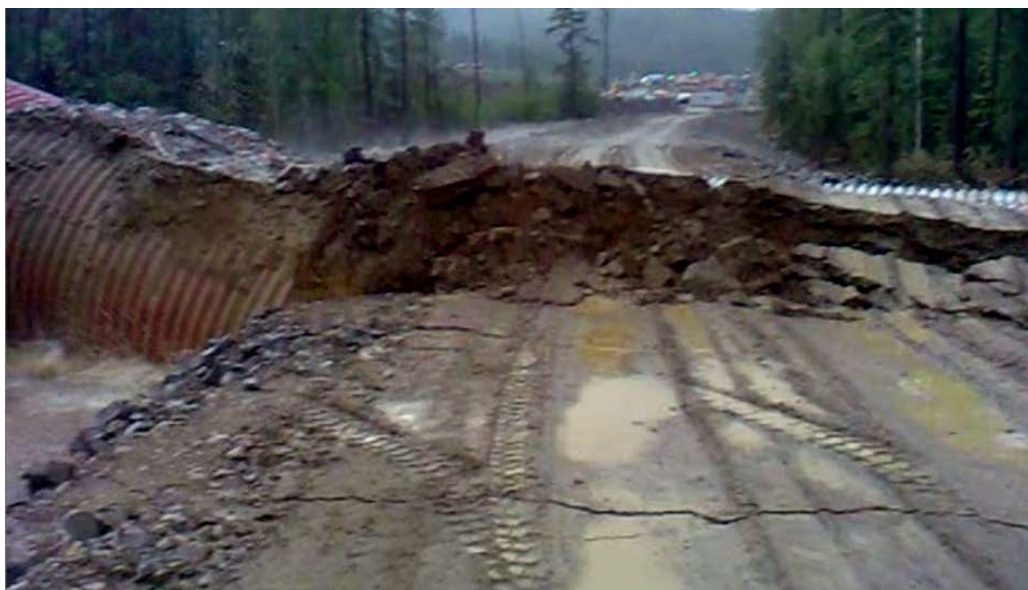
Рис. 1. Разрушение земляного полотна с верхового откоса
