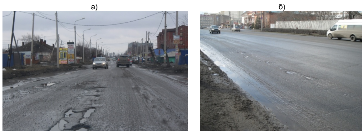
Рис. 2. Участок дороги: а) на ул. Демьяна Бедного; б) ул. Интернациональная
