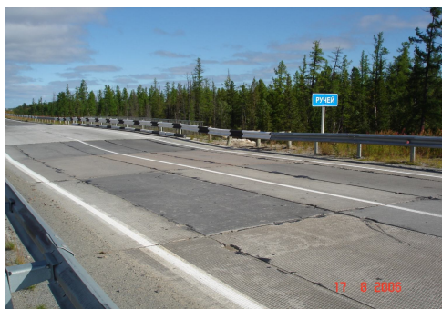
Рис. 1. Деформации насыпи на сопряжении с мостом
