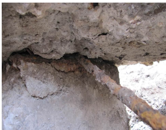
Рис. 2. Зазоры между сваяй и ростверком в результате пучения
