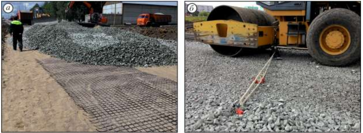
Рисунок 4.28 – Экспериментальная площадка трехслойной дорожной конструкции с песчаным слоем, армированным геосинтетикой: а – иллюстрация строительства опытной площадки; б – испытание опытной площадки
