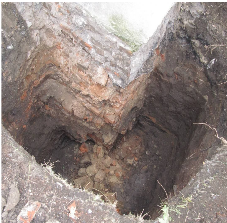
Рис. 1. Конструкция фундаментов наружных несущих стен. Расслоение кладки фундамента по толщине, размораживание кирпича и раствора. Угловые части фундаментов стен обваливаются под собственным весом
