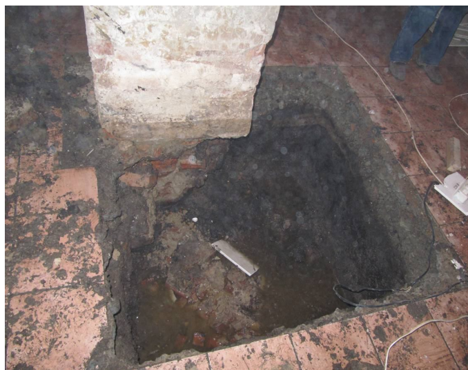
Рис. 2. Конструкция фундаментов внутренних несущих колонн. Кирпичный фундамент практически полностью разложился. За счет обрушения углов кладки фундамент заужен к подошве
