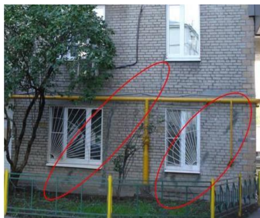
Рис. 4. Наклонные трещины в наружной стене в осях В/1-2
