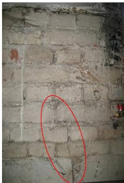
Рис. 3. Наклонная трещина в наружной стене подвала в осях В/1-2
